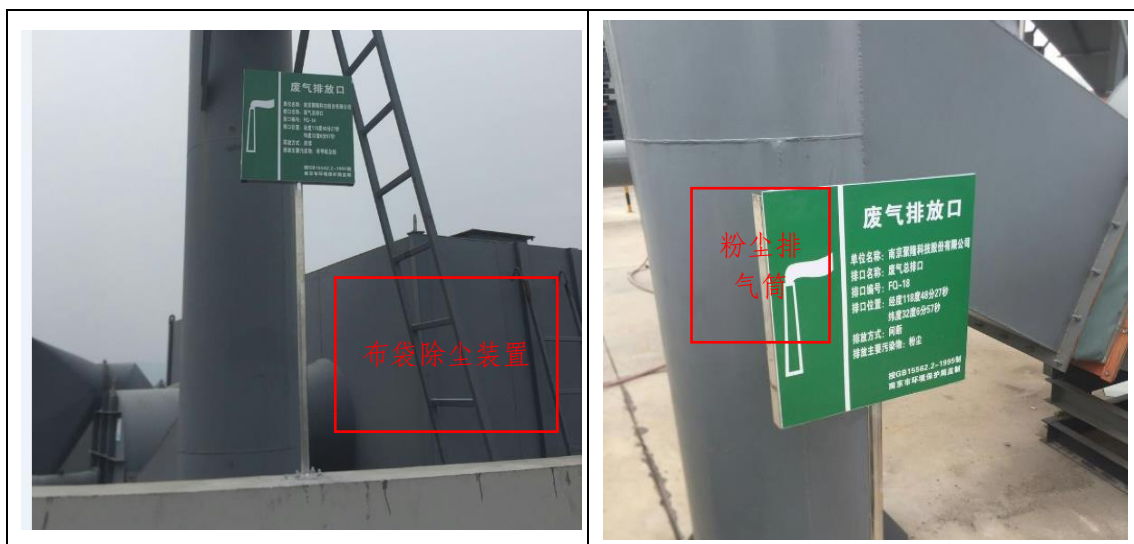
图 4.1-5 粉尘废气处理设施现场照片
